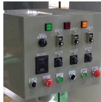
制御盤: 製造が大変
